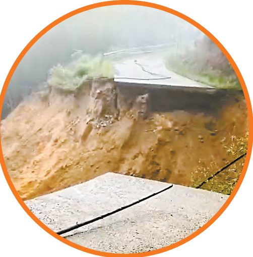
山体滑坡导致公路损毁。
