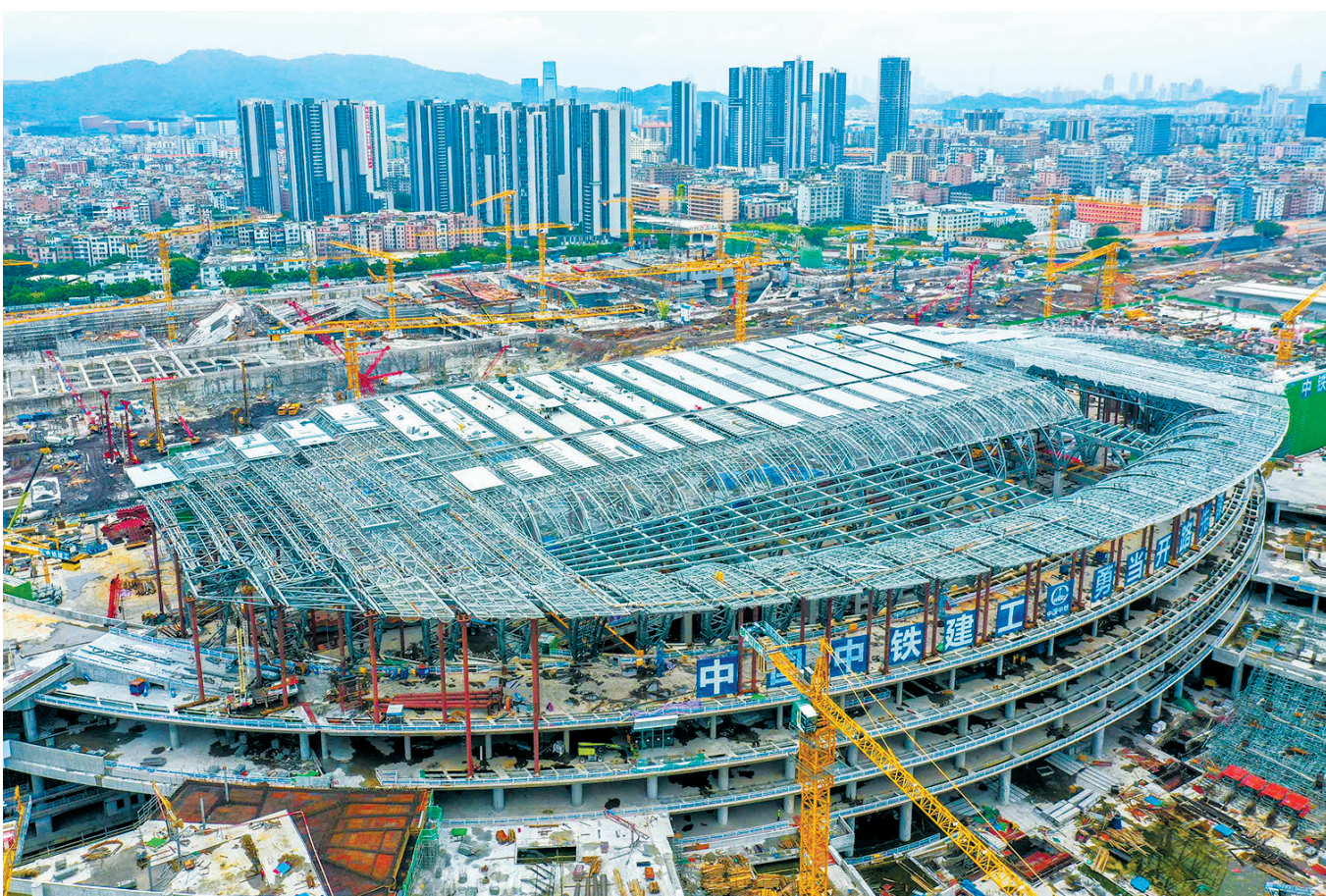
这是8月4日拍摄的建设中的广州白云火车站（无人机照片）。日前，中铁建工承建的广铁集团广州白云火车站（简称白云站）已完成一期工程主体部分的施工，车站“云山珠水、木棉花开”的外观造型雏形初现。新华社记者刘大伟 摄
