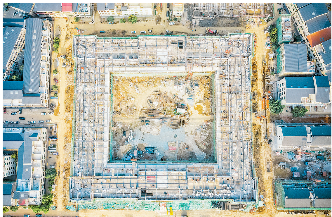
2月20日,位于龙南市的世界客家文化城项目现场,工人正在加紧施工。目前,世客会主会场已完成屋面钢结构主龙骨安装,预计4月前可移交布展单位进行装修。 黄梁森 摄
