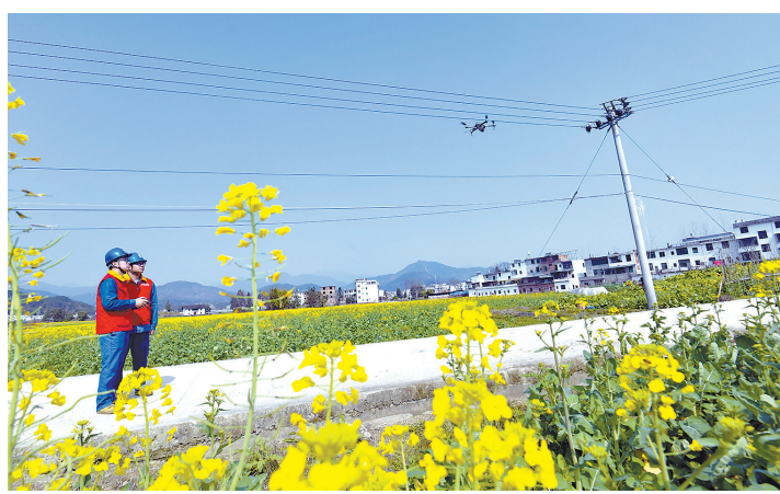
↑近日，工作人员在上犹县营前镇用无人机巡检电线。连日来，该县电力部门对排灌线路、设备等进行全面检查摸排，重点排查农户春耕抽水、灌溉等设备，全力保障春耕电力供应。记者肖靛 通讯员李新娇 摄
