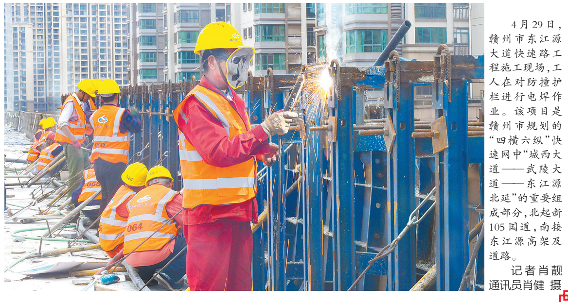
4月29日,赣州市东江源大道快速路工程施工现场,工人在对防撞护栏进行电焊作业。该项目是赣州市规划的“四横六纵”快速路网中“城西大道——武陵大道——东江源北延”的重要组成部分,北起新105国道,南接东江源高架及道路。 记者肖靓 通讯员肖健 摄
