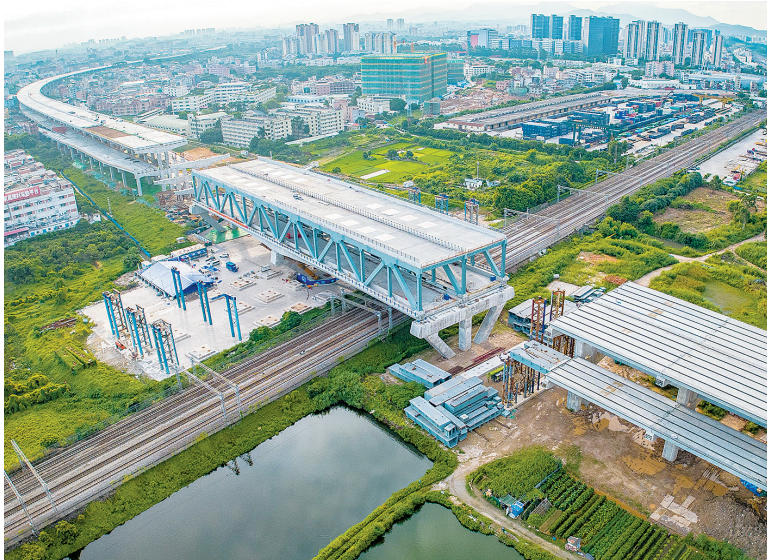
8月31日,莞番高速上跨广深铁路主桥转体完成(无人机照片)。当日凌晨,中铁十局承建的莞(东莞)番(番禺)高速上跨广深铁路主桥完成逆时针81.1°转体,填补了国内双层公路钢砼结合桥转体施工跨越运营铁路的空白。
