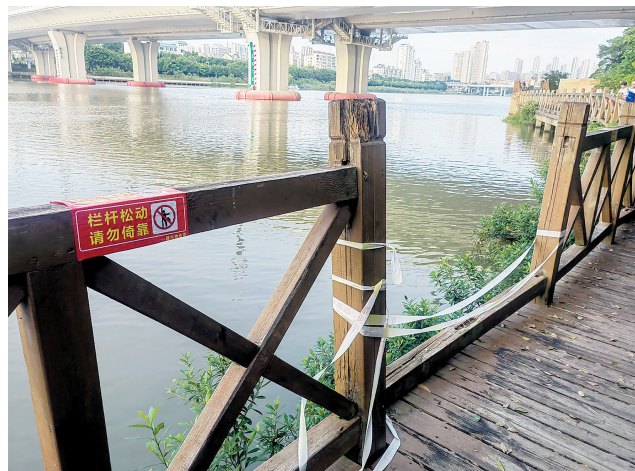
护栏破损严重。
