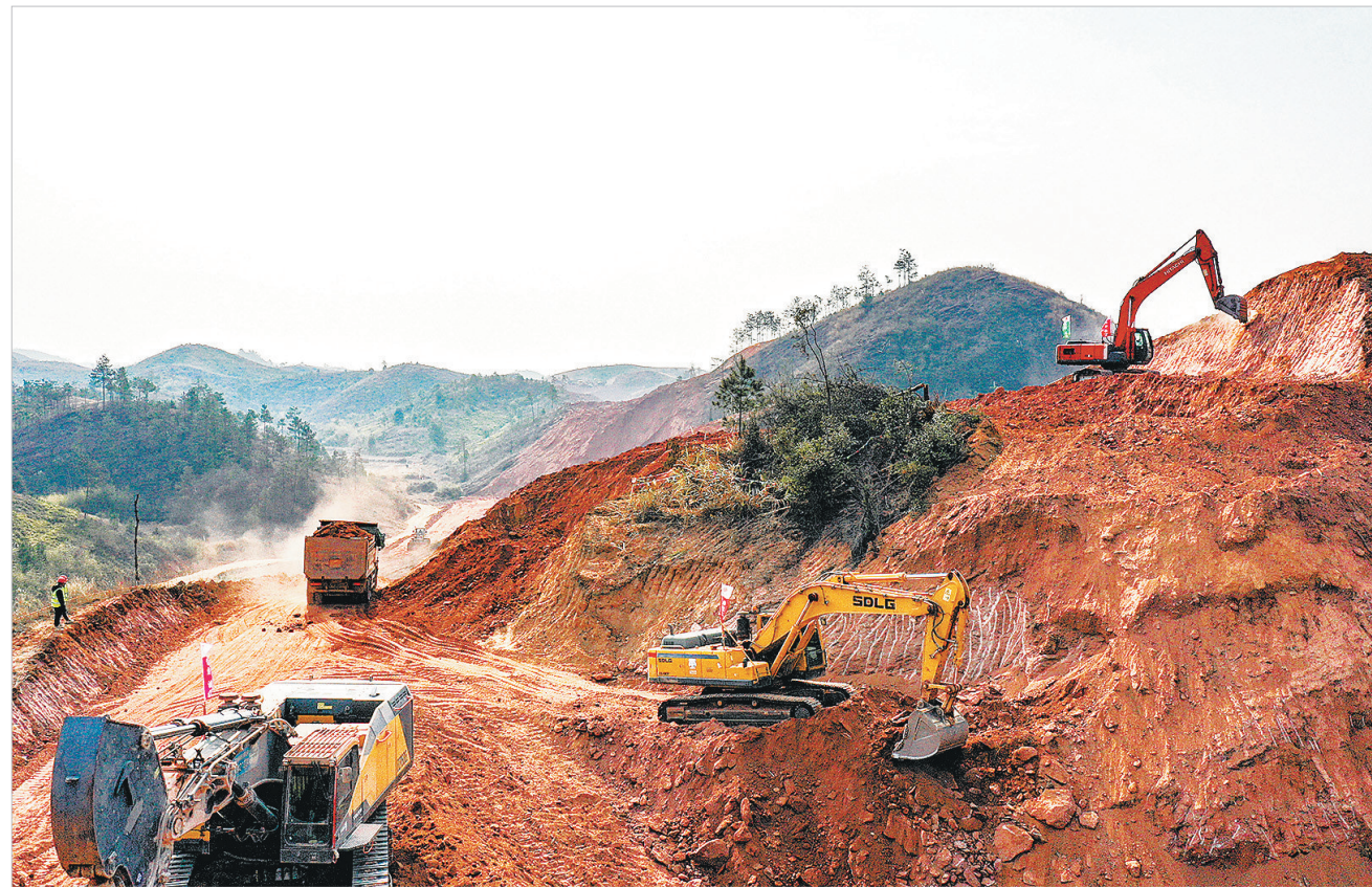
12月24日，瑞兴于快速交通走廊兴国段第一标段——G319瑞金至兴国改线工程富留龙至埠头垅上段项目现场，施工方正在有序开展土石方作业。该项目总投资14.43亿元，起点位于兴国县社富乡留龙村，终点位于该县埠头乡垅上村，路线全长21.477公里，设计为一级双向四车道快速路，预计2026年年底建成通车。
