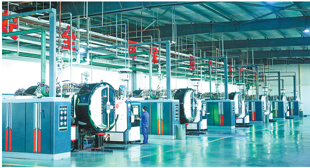
在位于大余县新华工业园内的江西翔鹭钨业有限公司烧结车间,工人正在巡检调试低压烧结炉生产程序。
