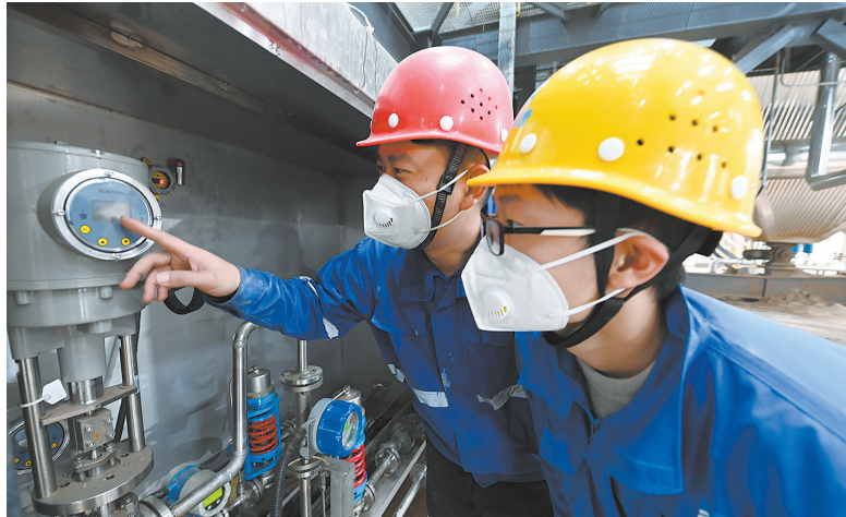
宁都县生活垃圾焚烧发电厂项目是省重点建设项目全部建成后可年处理生活垃圾39.6万吨,年上网发电量可达1亿千瓦时。
