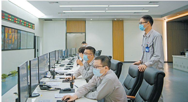
在信丰发电公司集控室内,运行操作人员精心监盘、细心操作,维护机组安全稳定运行。截至10月20日,信丰电厂年累计发电量突破32.2亿千瓦时。
