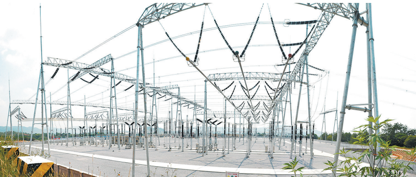
位于瑞金市沙洲坝镇境内的红都500千伏输变电工程投产送电,为瑞金、兴国、宁都、会昌等赣州东部6县(市)416万人口提供安全可靠稳定供电。
