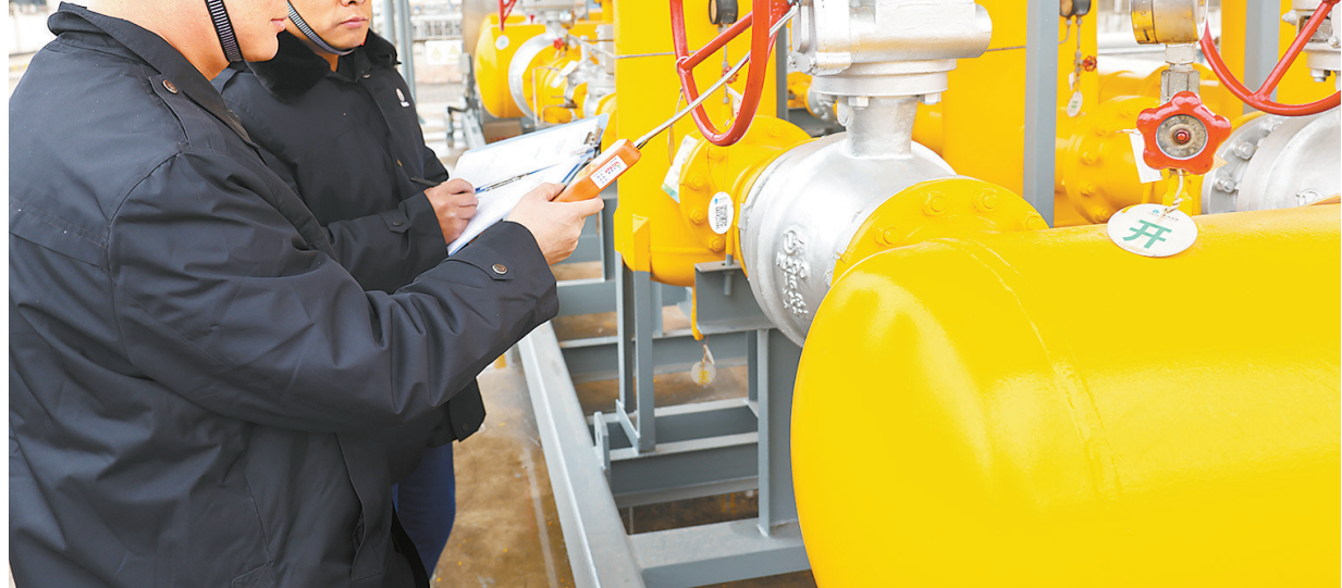
12月19日,工作人员在赣州经开区工业三路巡查气站燃气管道。为应对寒潮低温天气,连日来,赣州深燃天然气有限公司的工作人员加强对供气设施设备的巡查巡检和维护保养,对管道周边施工工地进行全面监管,保障管网安全运行和燃气供应稳定。 见习记者伍煜 特约记者潘萍 摄
